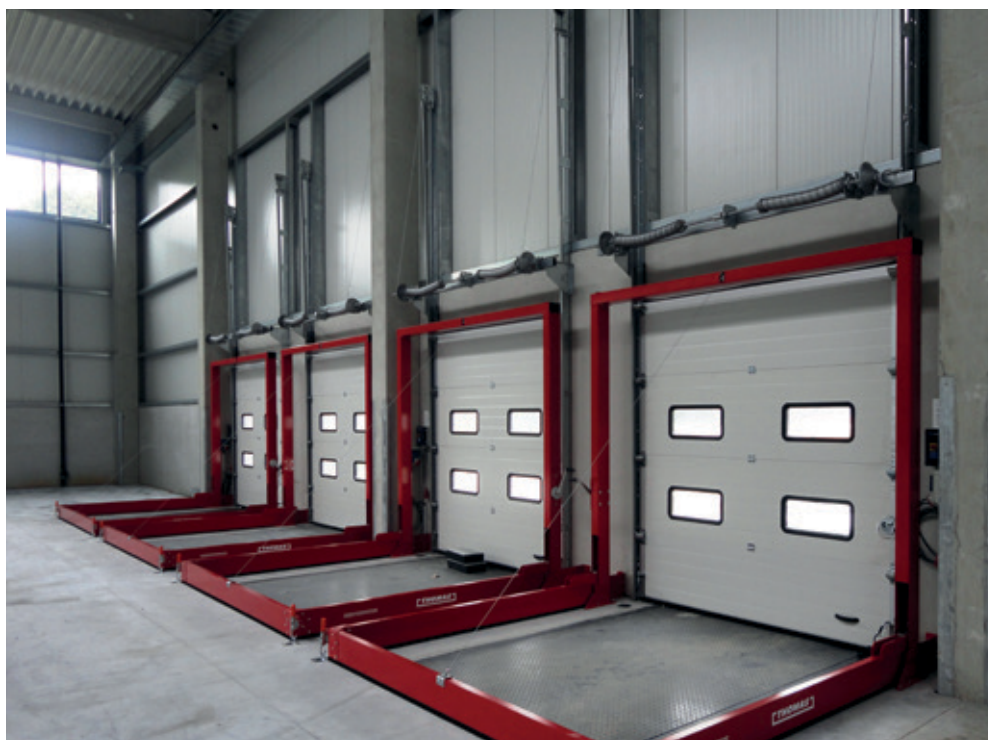
Manuelle Löschwasserbarrieren bei Laderampen
