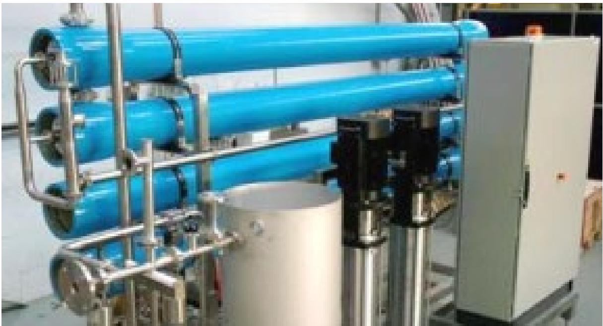
Abbildung 31: Einsatz einer Nanofiltrationsanlage (Anlage der MMS AG)
