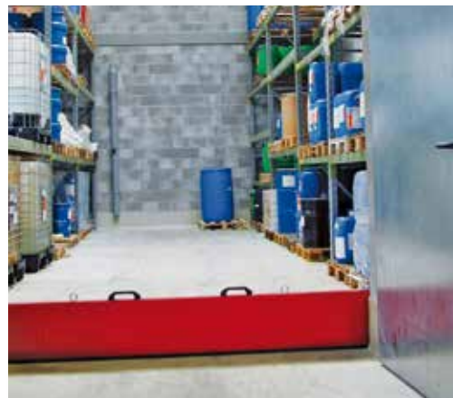
Leckage-/Löschwasserrückhalt (Bildquelle: Amt für Umwelt, Kt. TG)
