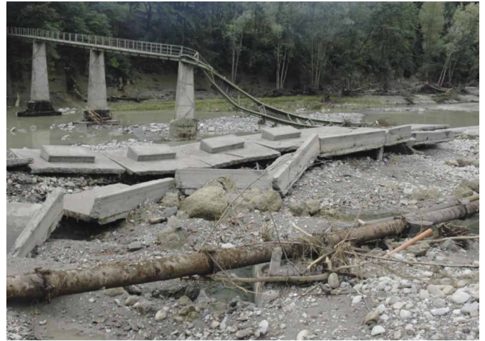
Hochwasserschäden bei der Staumauer der Magerau © AfU
