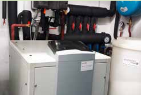
Wärmepumpe © chammartin & spicher SA
