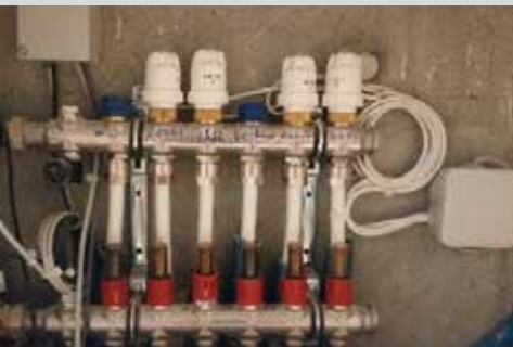
Anschluss der Thermostaten © R. Jobin
