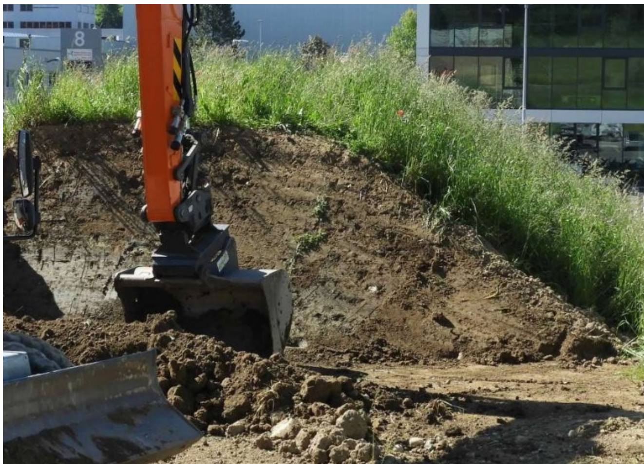
Kontrolle des Umgangs mit dem Boden auf einer Baustelle, Echarlens, 3. Juni 2020 (Foto AfU)
