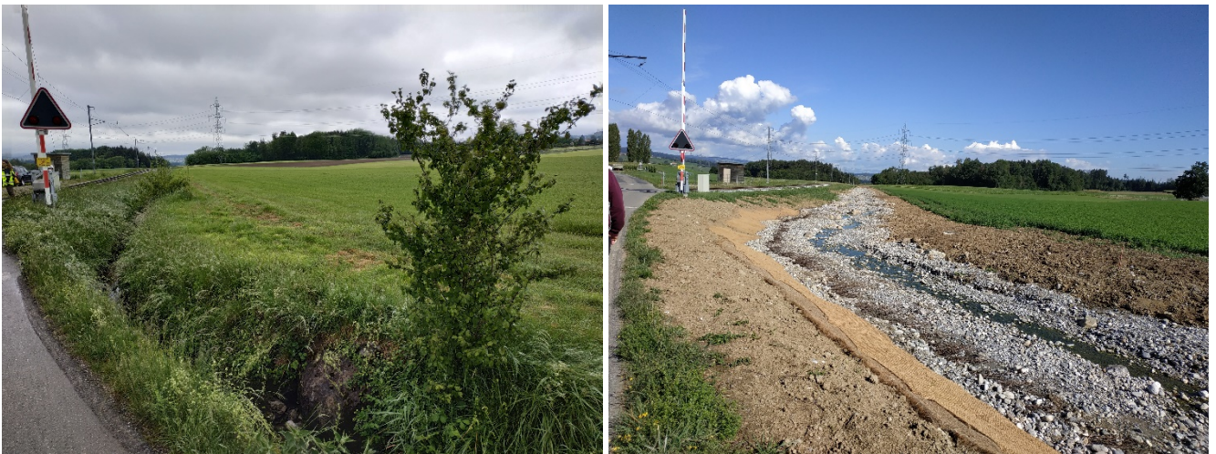
Der Bach La Goletta in Bossonnens wird 2020/2021 revitalisiert (Foto AfU vor und nach den Arbeiten)
