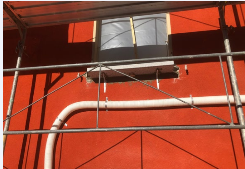
Die Hauswand ist nach der Dämmung rund 20 cm dicker, durch die Dämmschicht verlaufen die neuen Belüftungsrohre.
