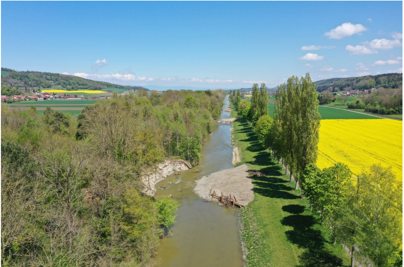
Revitalisierung der Broye in Villeneuve (Fotos während der Bauarbeiten, die Bepflanzung ist für 2022 geplant), 3. Mai 2021, © Anyscreen
