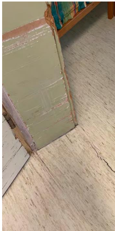
Schäden im Inneren
