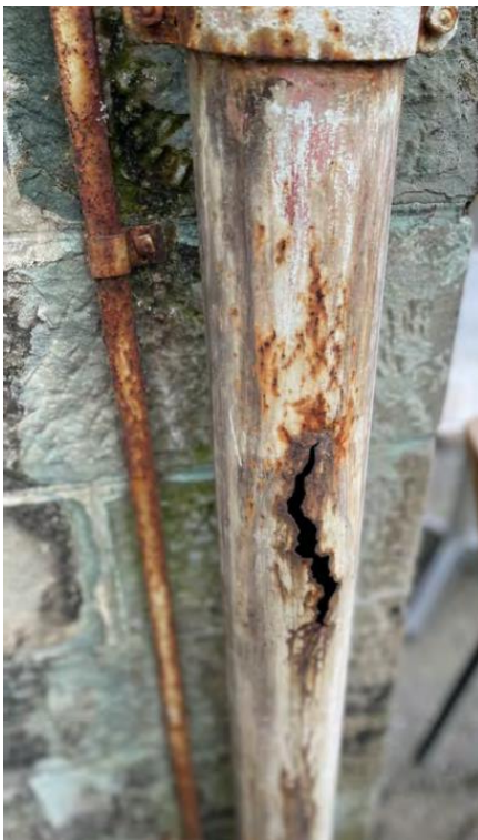
Schäden an der Hülle
