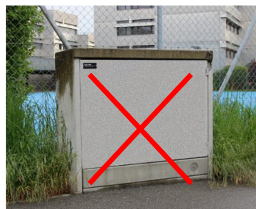
Elektro- oder Telekommunikationsschrank
