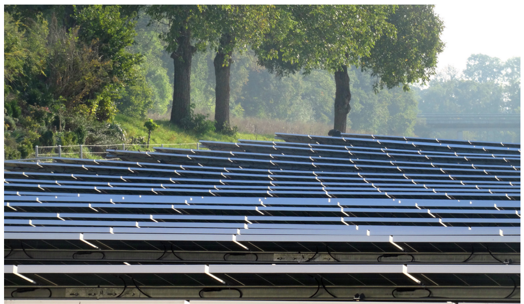
Foto 4.3: PV-Freiflächenanlage mit 6 MW Leistung in Payerne (VD), in Betrieb seit September 2015. Quelle: NET AG
