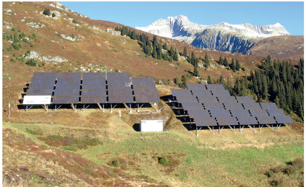
Photo 4.5: Installation photovoltaïque de 97,78 kW à Caischavedra (GR) mise en service en mai 1993, avec une production d’électricité en hiver particulièrement intéressante. Source: NET SA
