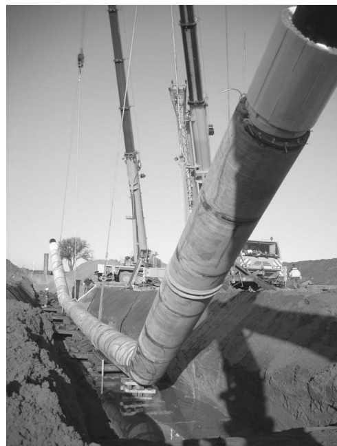
Bild 4.21 Vorgefertigter Düker wird in die Dükerrinne gehoben um danach auf Rollen in das Flussbett geschoben zu werden [51].
