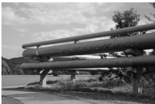
Bild 4.18 Oberirdische Fernwärmeleitungen in Jena (Stadtwerke Energie Jena-Pössneck).
