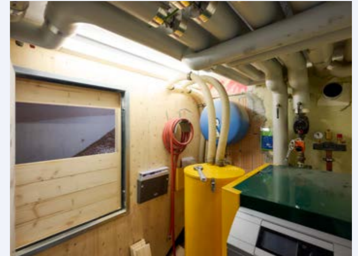
Die Pellets-Heizung macht kaum Geräusche und arbeitet sehr effizient.
