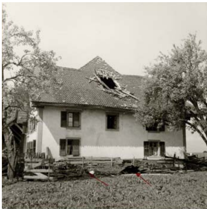
Endroit où la foudre a atteint la ferme, sur la cheminée qui a été pulvérisée. Flèches: débris de poutres et planches projetés provenant du toit et de la cheminée.
