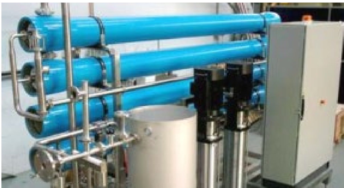
Figure 31 : Installation de nanofiltration (usine de MMS AG).
