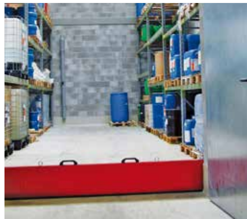
Rétention des fuites/des eaux d'extinction (Photo : Office de l'environnement, TG)
