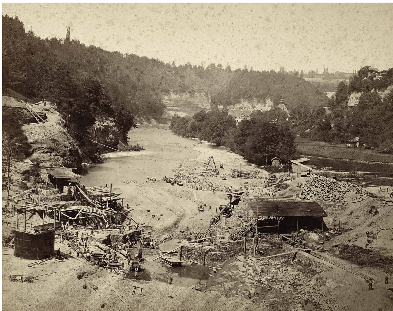
Construction du barrage de la Maigrauge (1872). © BCU. Collection de photos sur carton
