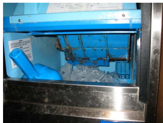
Nettoyage insuffisant d'une machine à glaçons – rouille
