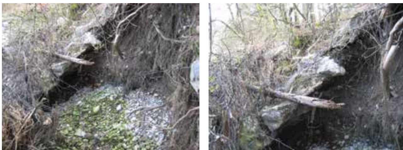
Figure 3-9 Érosion des berges de la Pila après la crue de 2005 (crue centennale)
