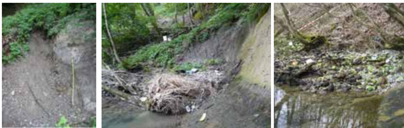
Figure 3-8 Glissement zone « Hot spot » (photos de 2008)
