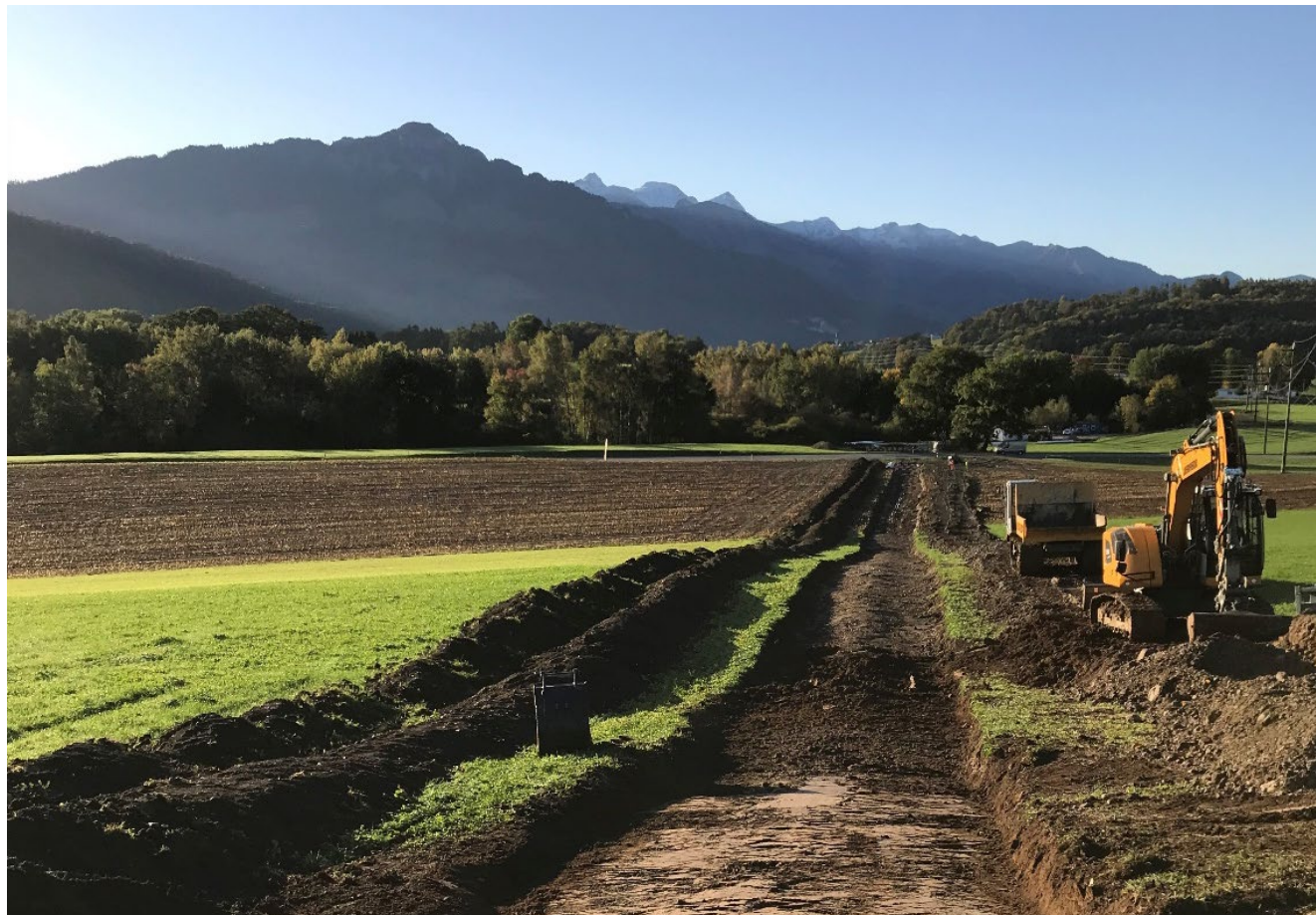
Contrôle de la gestion des sols sur un chantier, Echarlens, 16 octobre 2019 (photo SEn).
