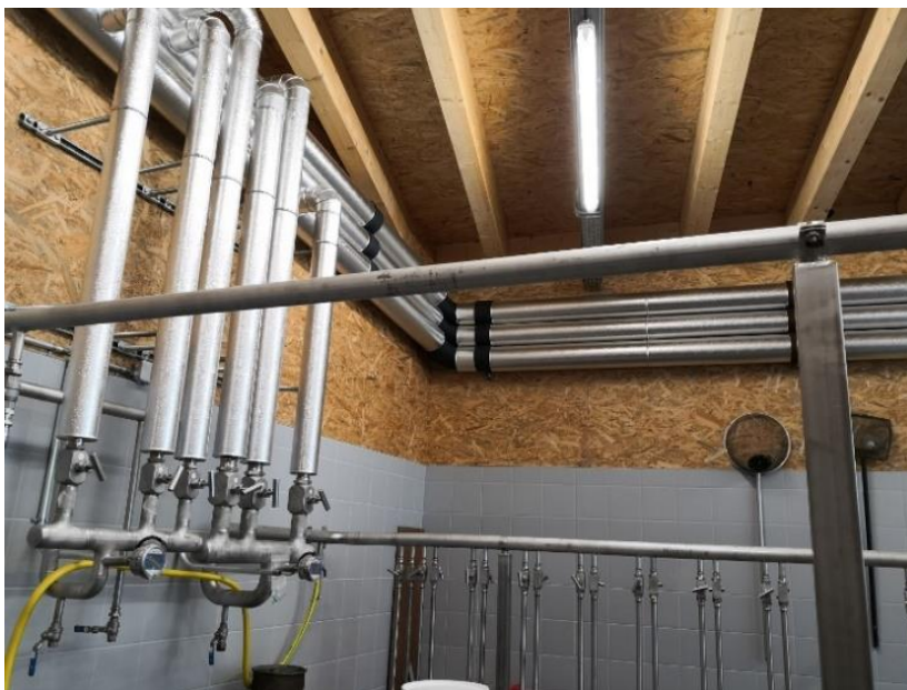
Figure 6 Tuyauteries dans la salle de production
