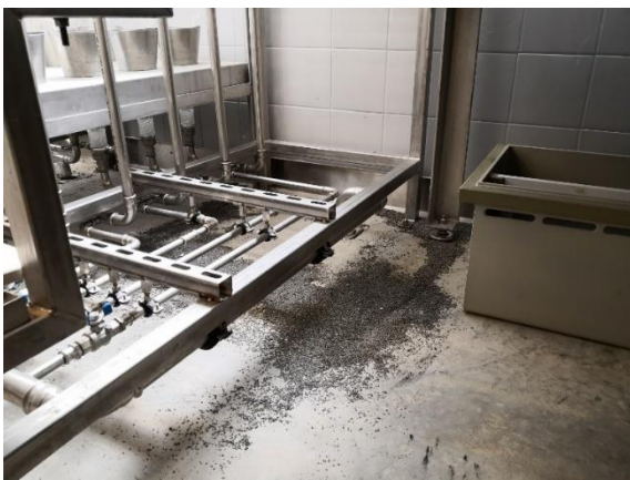
Figure 24 Problème de retour de matériel de filtration dans les canalisations
