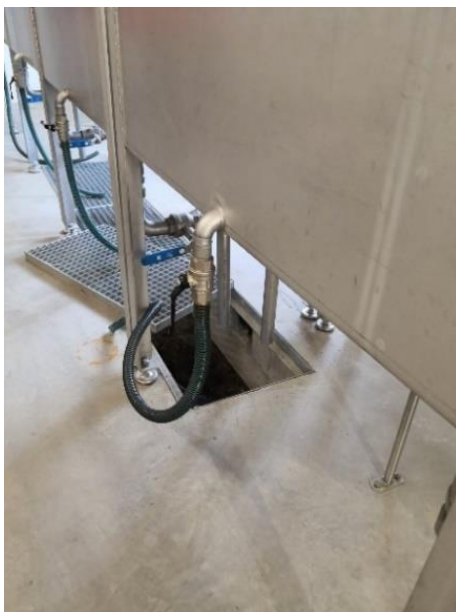
Figure 22 Unique canal d'évacuation d'eau de la salle d'incubation/éclosion
