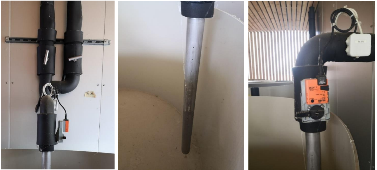
Figure 21 Arrivées d'eau du lac ou du réseau, tuyau d'entrée d'eau du bassin et vanne de régulation du débit
