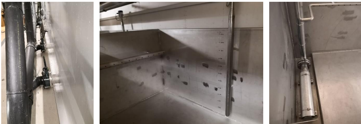
Figure 4 Cuves de réserve d'eau
