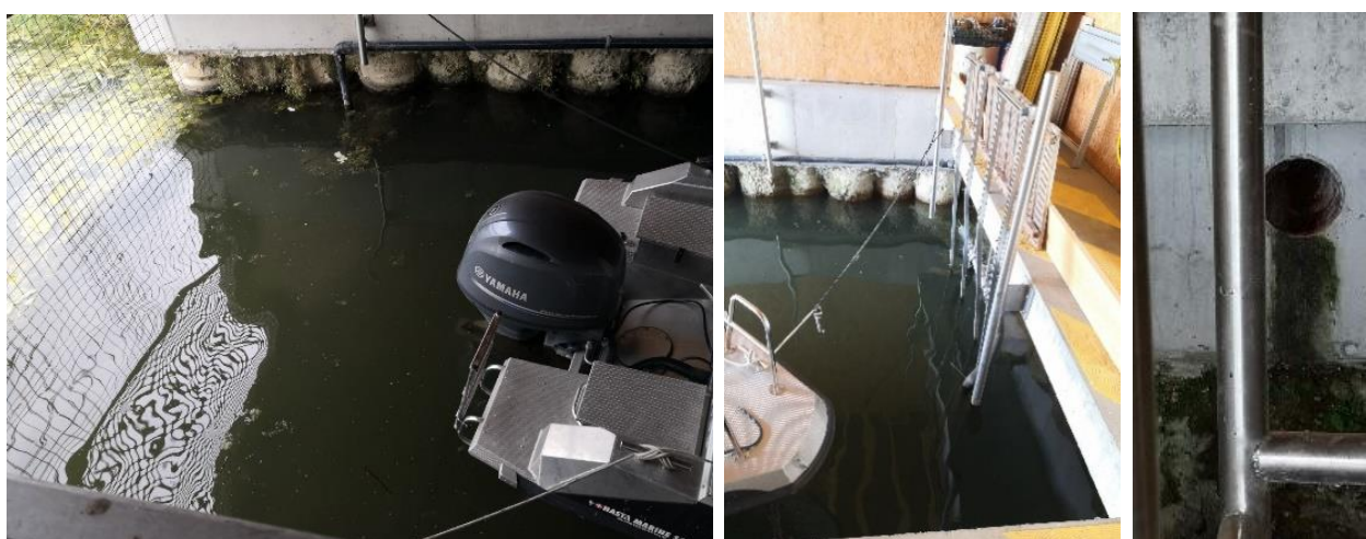
Figure 2 : Hangar à bateaux, prise d'eau et tuyauterie de rejet
