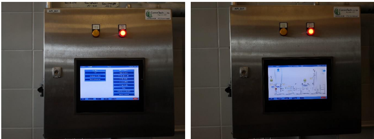
Figure 8 Panneau de contrôle du système d'alarme
