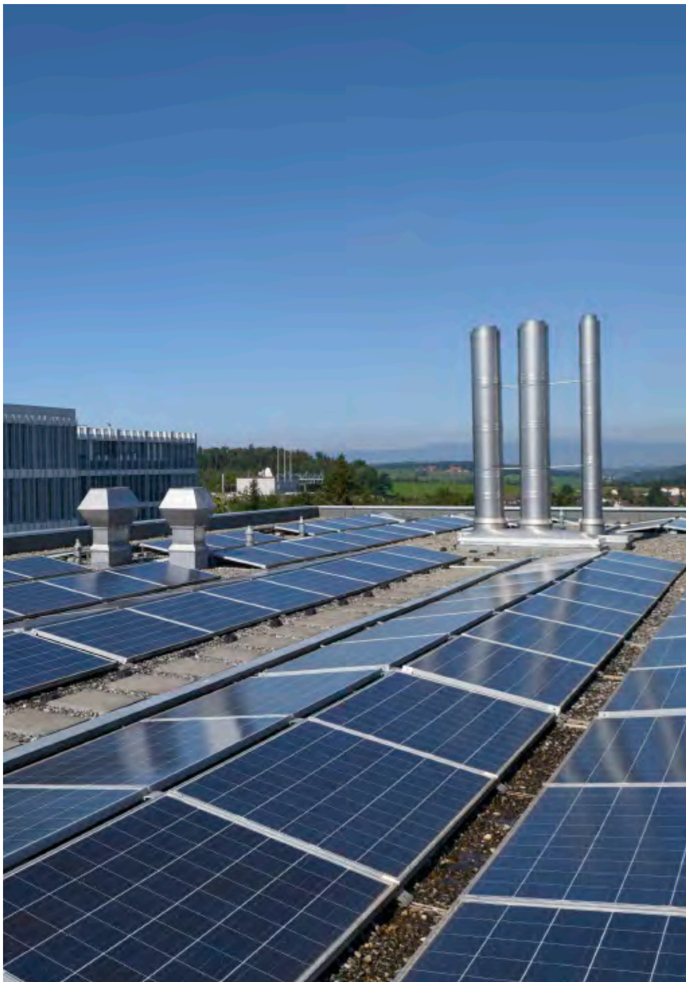
Les toits de plusieurs bâtiments de l'État ont a été équipés de panneaux photovoltaïques.
