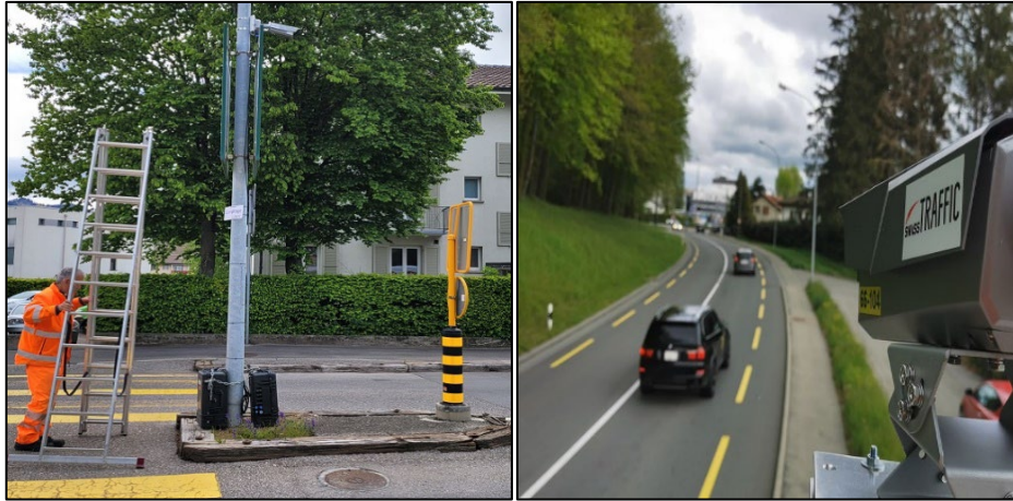
Figure 7 : Installation des caméras par SWISSTRAFFIC à Bulle (gauche) et Villars-sur-Glâne (droite)
