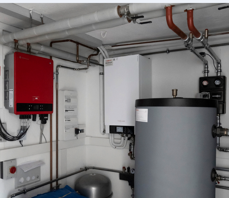
Avec le retrait du chauffage électrique, la famille a gagné en espace de rangement dans la cave.
