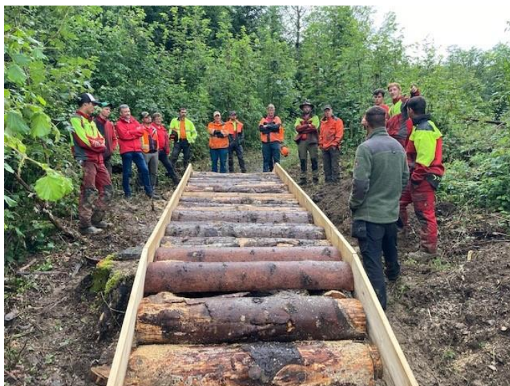
Travaux sur un parcours VTT sur la commune de Bulle lors de la visite des formateurs au CI génie forestier le 8 juillet 2021
