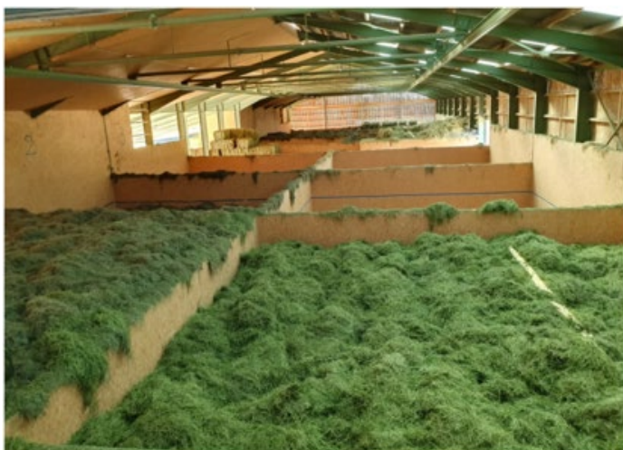
Image 5 : Récupération de chaleur sous toiture pour les séchoirs en grange
