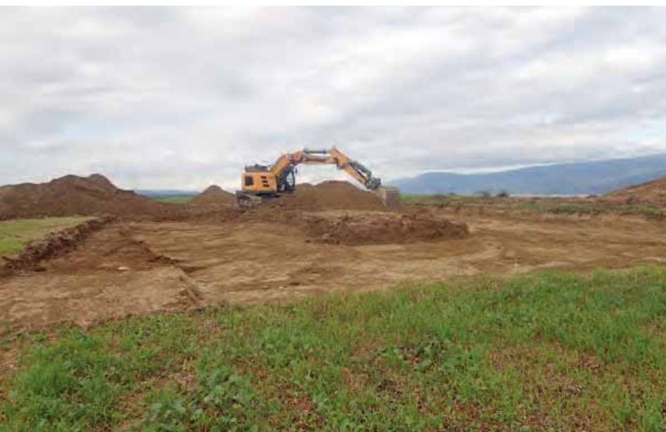
Fig. 48 Dégrappage de surface sur les hauts de Saint-Aubin, au lieu-dit Route du Mont
