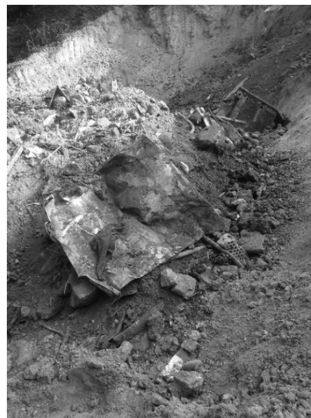
Figure 3 – Dernière phase des travaux d'assainissement de la décharge du Bois de la Cigogne à Torny
