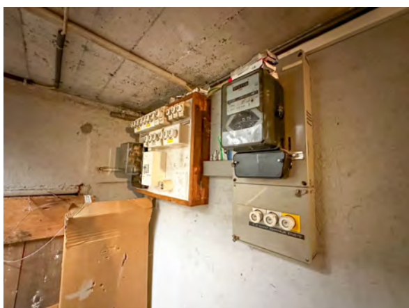
2 ème tableau électrique
