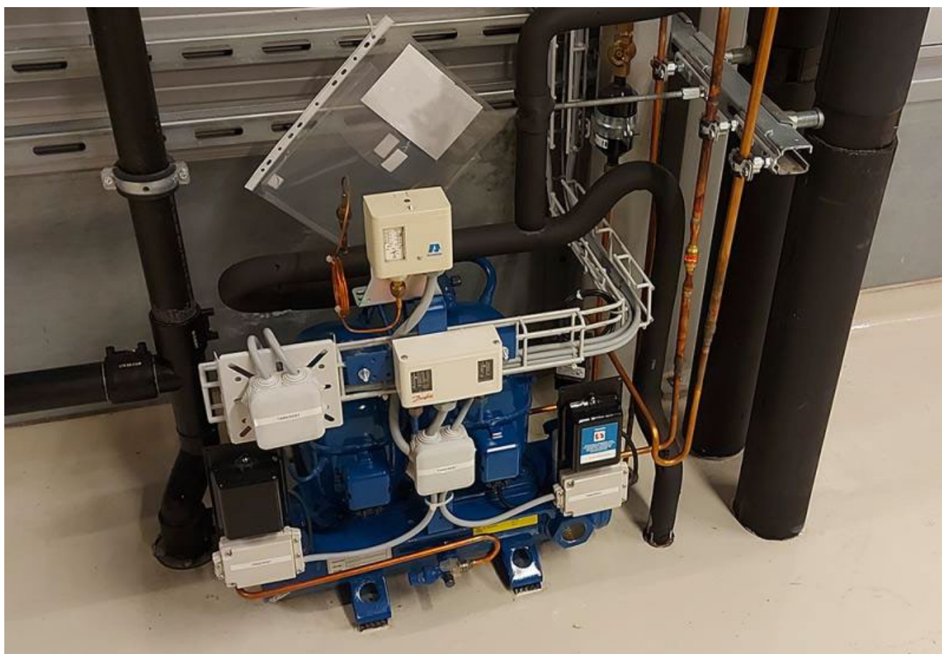
Installation pour la réfrigération de denrées alimentaires. © SEn
