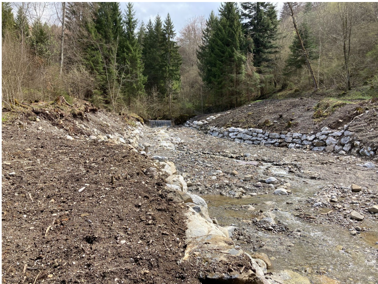
Ruisseau des Branches - construction d'un dépotoir à matériaux- commune de Hauteville. © SEn
