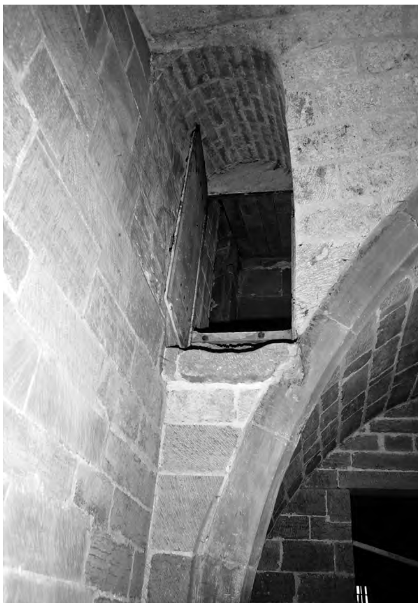
Fig. / Abb. 32 Porte d'accès au jubé, ménagée au XVI e -XVII e siècle dans la voûte de la sacristie gothique Die im 16.-17. Jahrhundert angelegte Tür zum Lettner im Gewölbe der gotischen Sakristei
