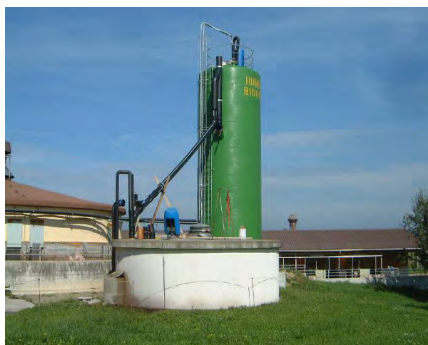
Photo 1: Production de biogaz à Bösinggen (Nicolas Rossier).
